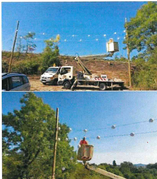
Illustrations d'un dispositif de guidage mis en place sur l'A75 (source : L'Entreprise Électrique)
